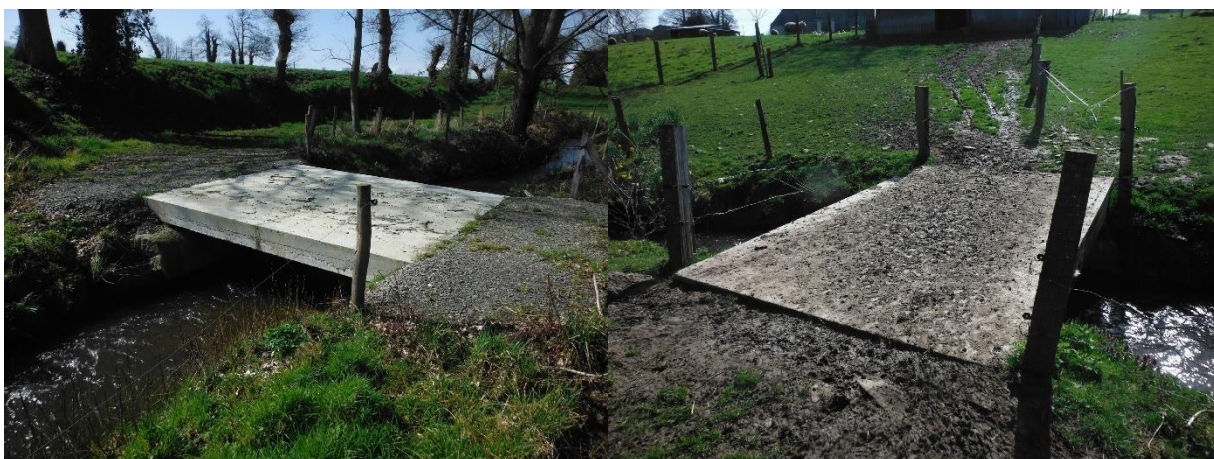
Passerelles en béton aménagées sur le bassin versant du Couesnon aval – Source : Hardy Environnement
